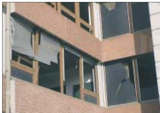
Etablissement scolaire endommagé
